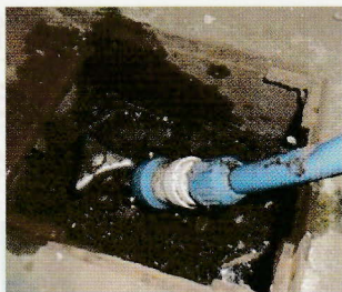
▲ 水の溜まった埋設型散水栓
